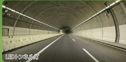
LEDトンネル灯
